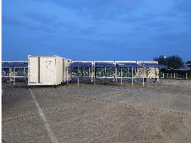
Photo 2: Energie bei Nacht: Solarstrom wird im Batteriespeicher zwischengespeichert und zu einem späteren Zeitpunkt zur Verfügung gestellt.
